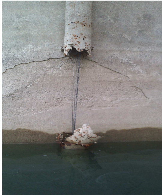
Компрометиран участък нивомерна тръба Яз. стена „Ст. кладенец“
